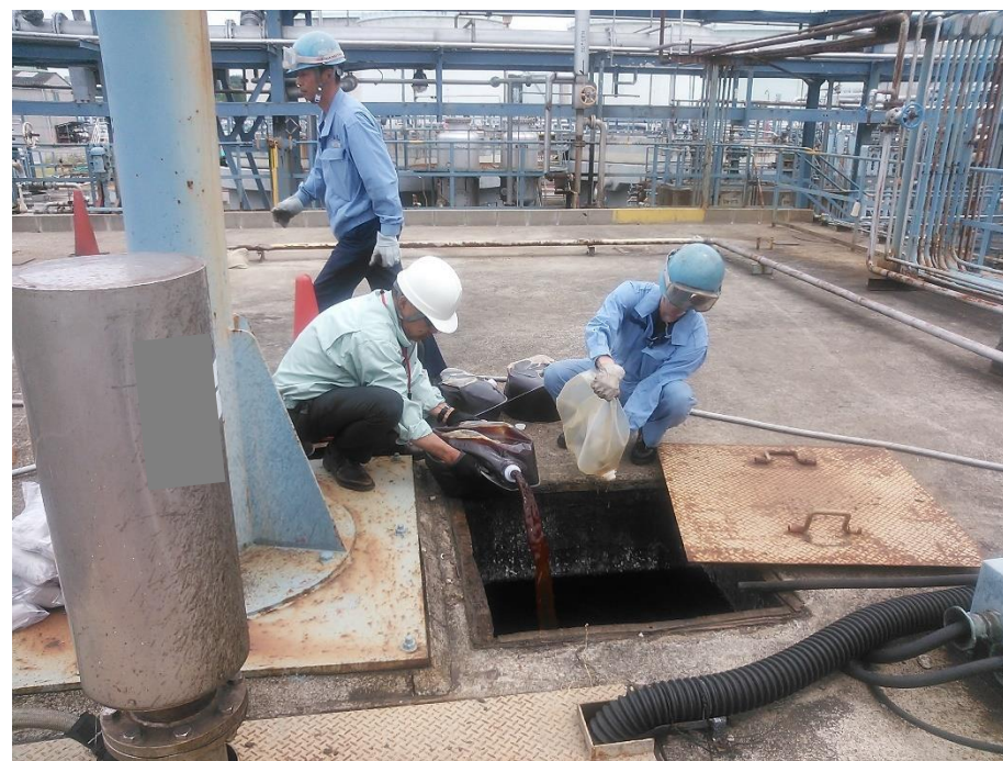
コンクリート下が曝気槽
